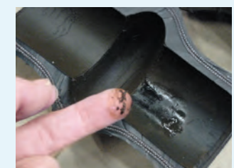
上水ラインのゴム劣化によるカーボン流出事例
